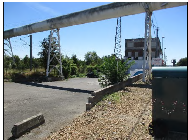
Figure 33 : Tronçon N°2 : mur de soutènement d'un parking dans talus, côté Oise (source : Artelia)
