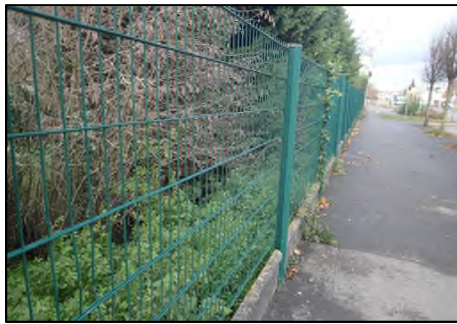
Figure 48 : VTA - Désordre - tronçon 3bis : végétation dangereuse (source : Rapport VTA, ISL, 2020)
