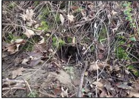
Figure 47 : VTA - Désordre - tronçon 3 : terrier (source : Rapport VTA, ISL, 2020)
