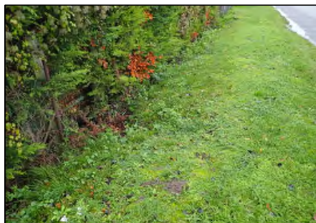
Figure 45 : VTA - Désordre - tronçon 2 : dépression (source : Rapport VTA, ISL, 2020)
