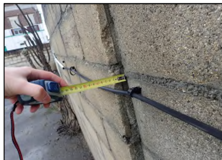
Figure 46 : VTA - Désordre - tronçon 2 : déversement du mur (source : Rapport VTA, ISL, 2020)
