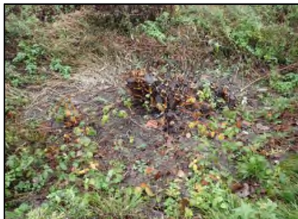
Figure 43 : VTA - Désordre - tronçon 1 : souche (source : Rapport VTA, ISL, 2020)
